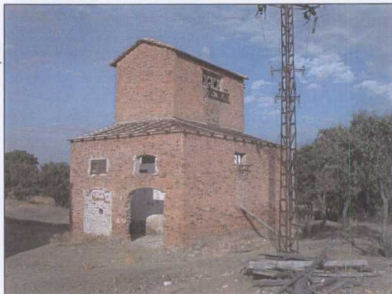
VZ003.- Caseta del transformador eléctrico.
