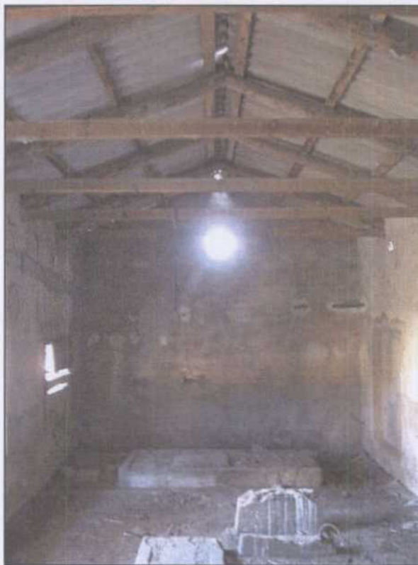
CP004- Interior de la casa de máquinas del pozo central.
