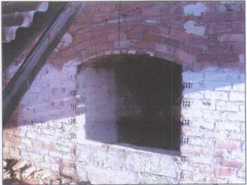
CP009- Lavadero de flotación. Salida de descarga del silo de almacenaje del todo-uno.
