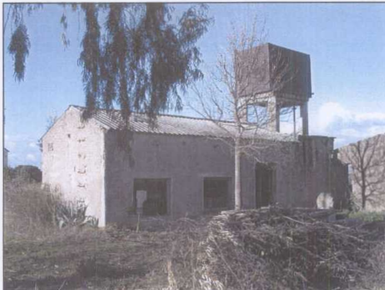
CP004- Casa de máquinas del pozo central.
