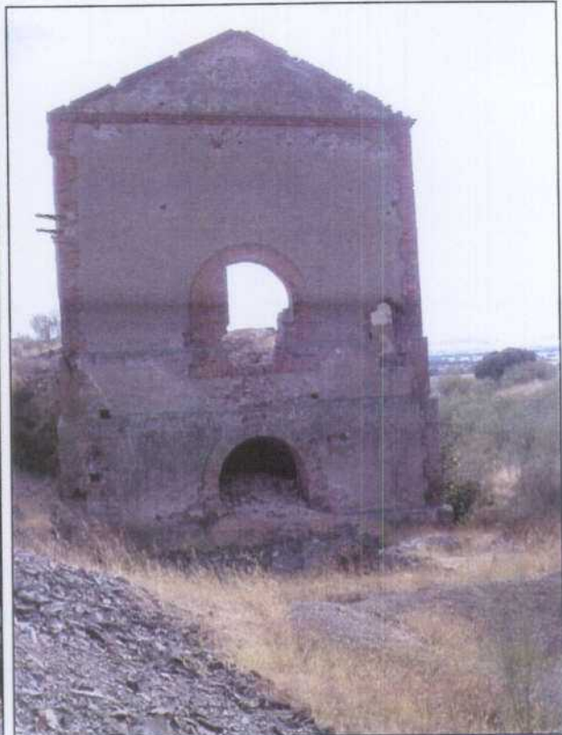
SQ001.- Vista de la fachada trasera de la casa de máquinas del pozo Don Raimundo. Arriba figura la fecha de 1901.
