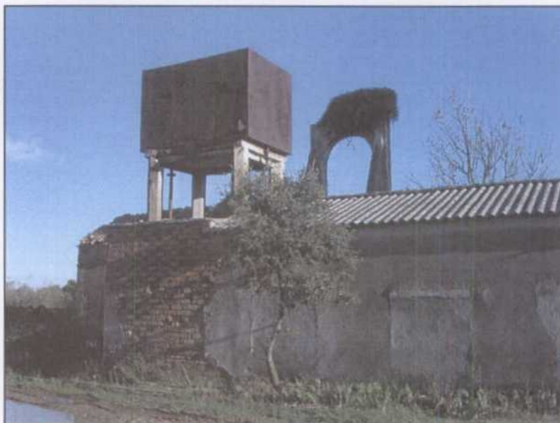
CP004.- Depósito metálico para regulación del agua bombeada de la mina.
