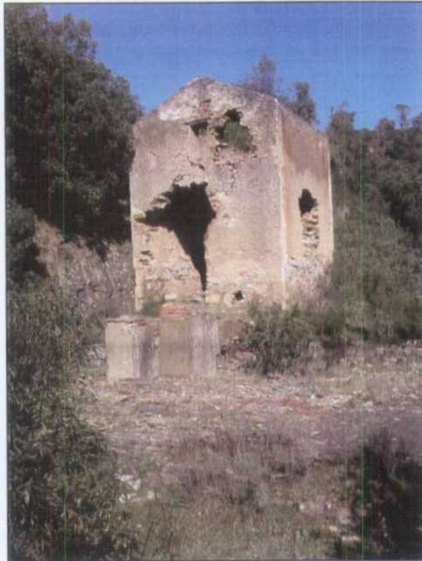
PT013.- Caseta del transformador eléctrico para suministro del pozo de la mina Santa Isabel.
