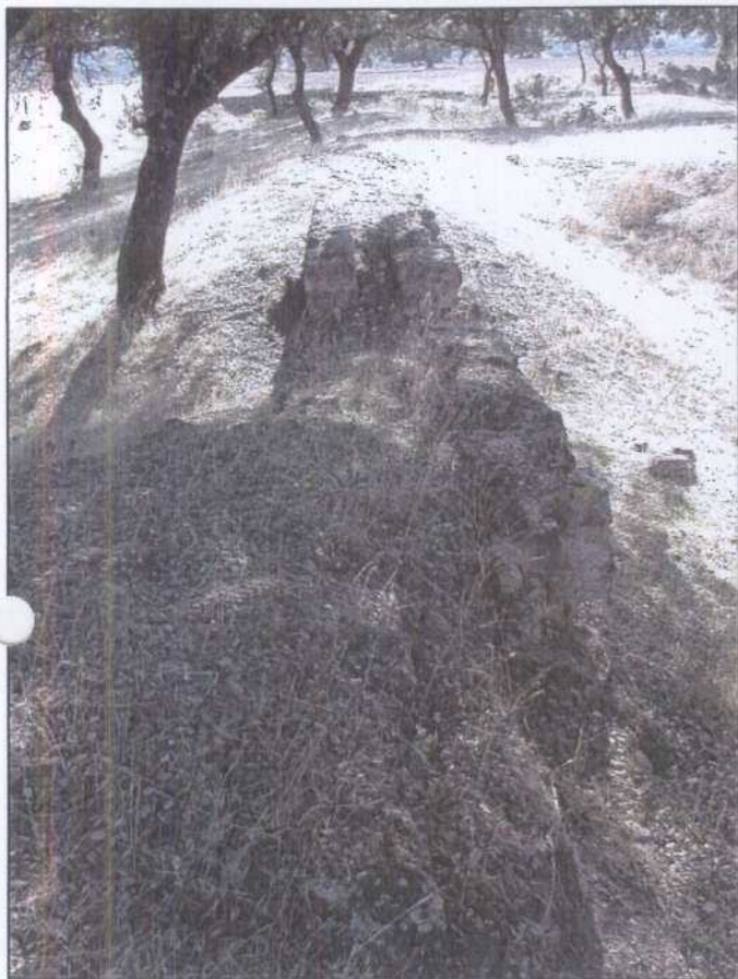
VG002.- Canalización de agua desde el pozo Buenahora hasta el depósito de acumulación .
