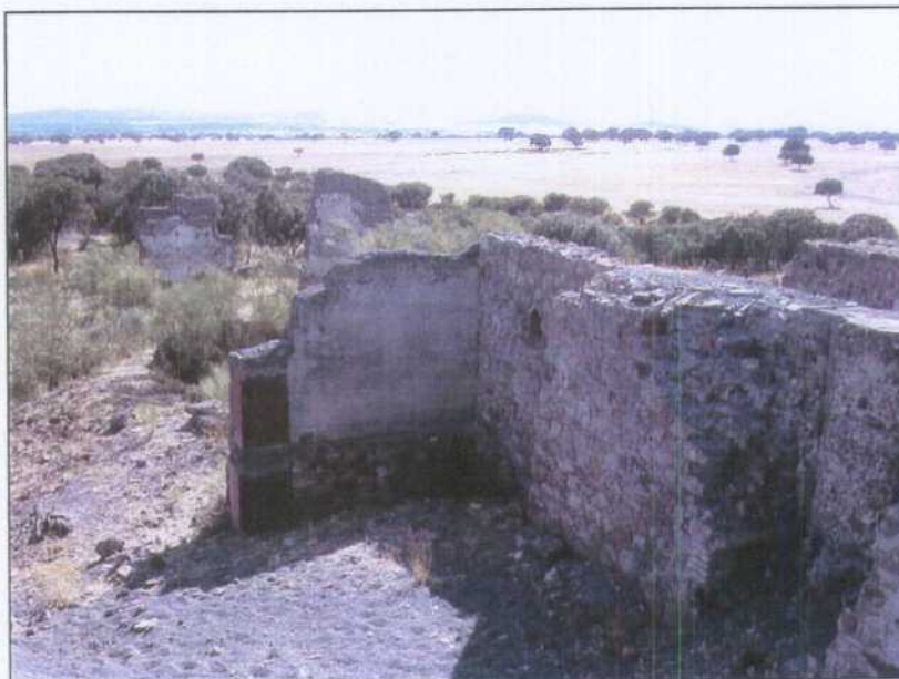
SQ013.- Estructura de mampostería y restos de la casa de máquinas del pozo Armando.
